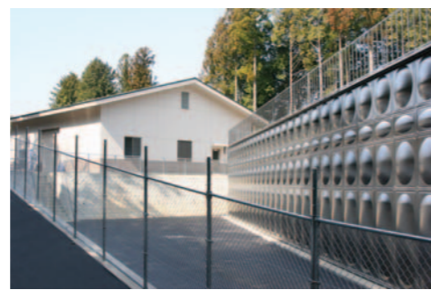
田口簡易水道浄水場
